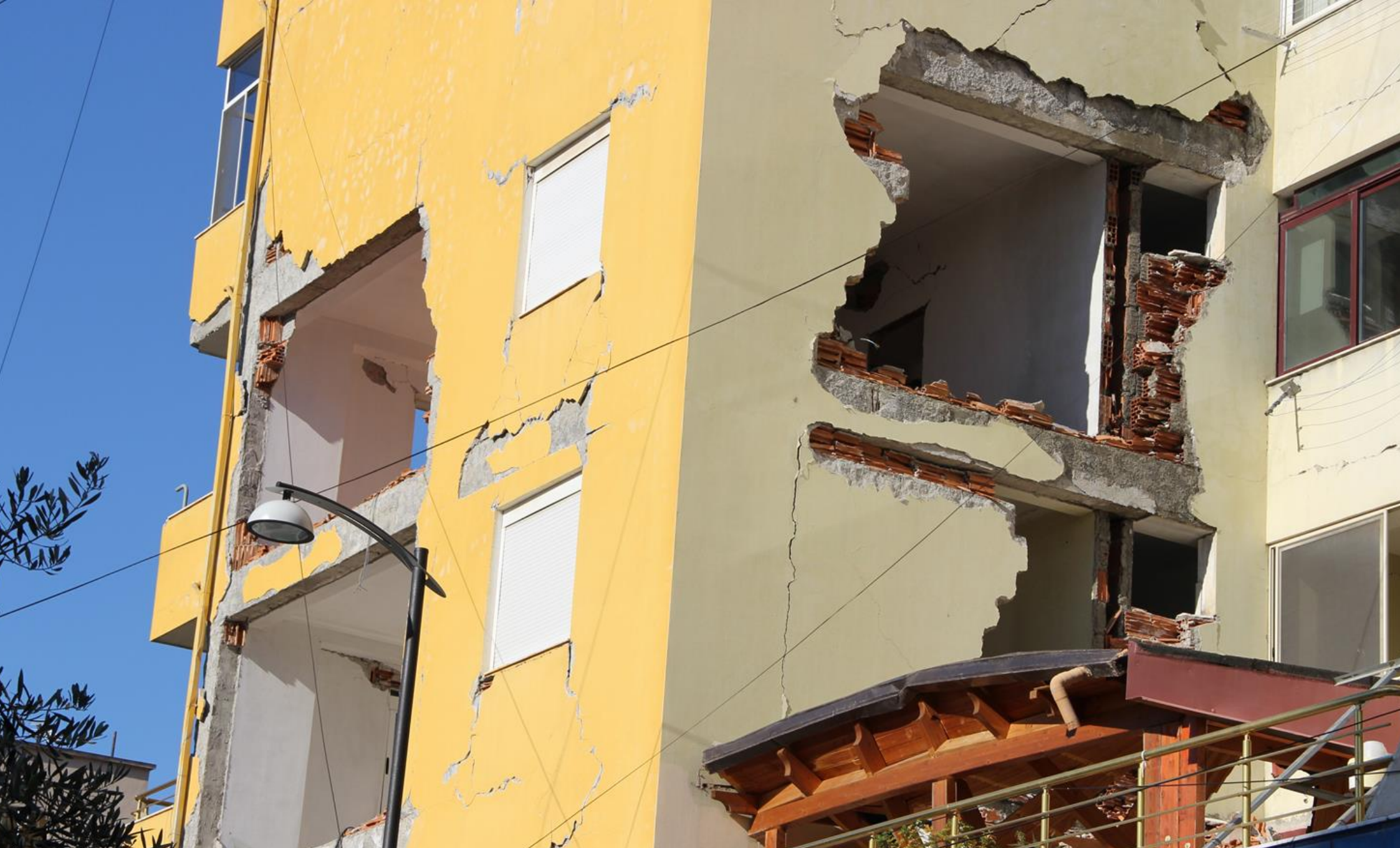
Oštećenja armiranobetonske okvirne konstrukcije s ispunskim zidom u Draču (Albanija) nakon potresa M_w=6,4 koji se dogodio 26. 11. 2019. g. (uviđaj radne skupine American Concrete Institute (ACI) Technical Committee 133 Disaster Reconnaissance)
